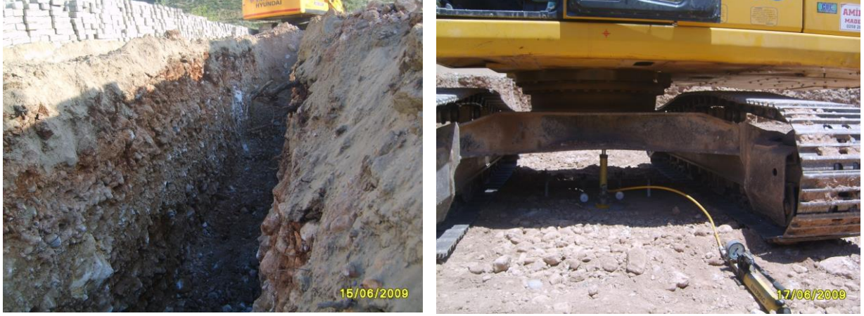
Şekil 4. Sondajlı zemin araştırması ile bilgi alınmayacak bir yamaç molozu istifi ve aynı birim içinde temel seviyesinde yapılan plaka yükleme deneyinden görünüm.
